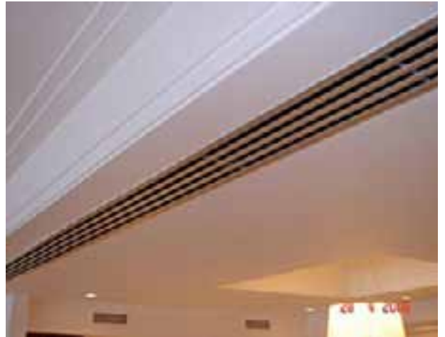
Ar condicionado central
